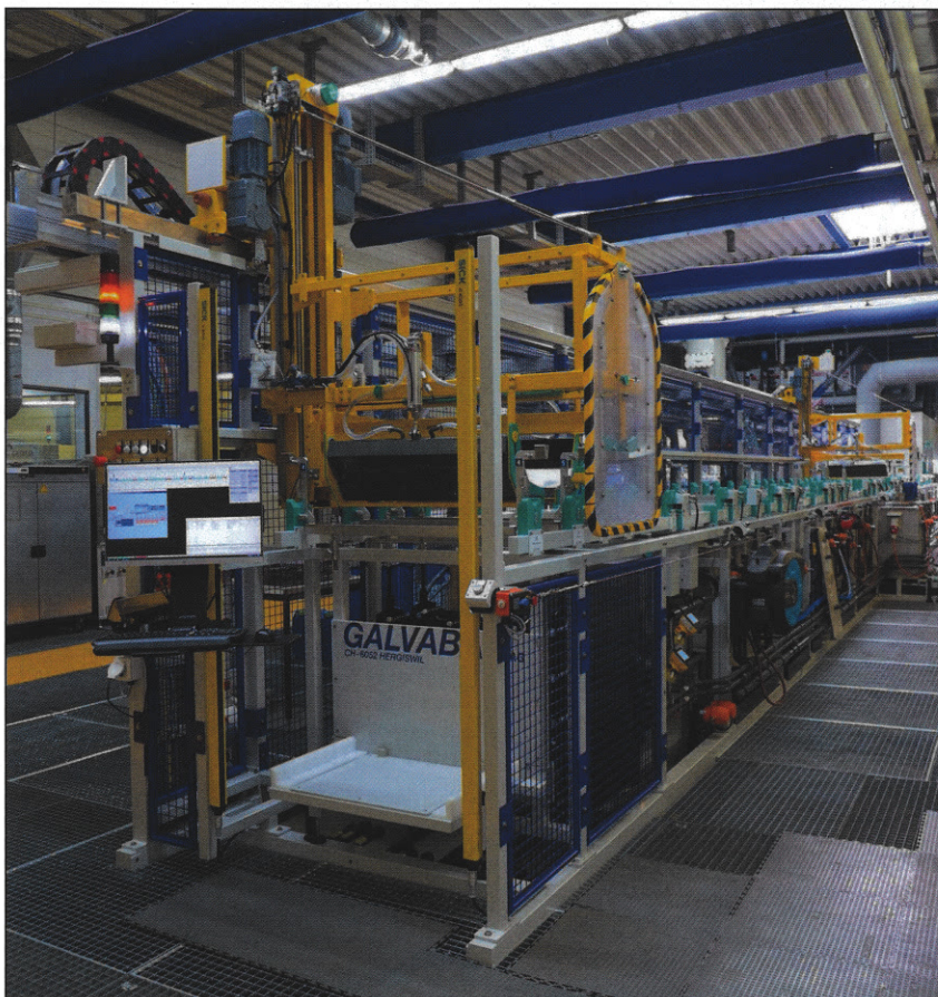
Die massgeschneiderte SMT-Anlage für chemisch Nickel, Gold und Palladium verfügt über 29 Stationen.
